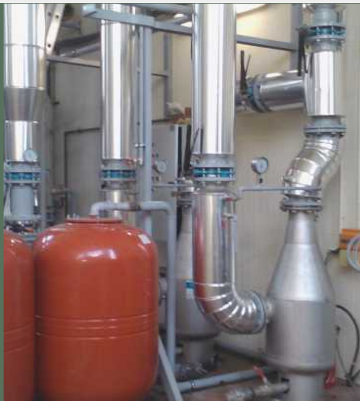
2 filtres HM 100 dans chaufferie
