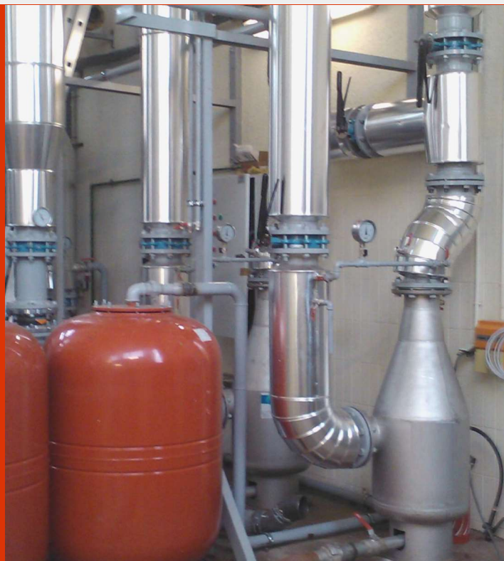
2 filtres HM 100 dans chaufferie
