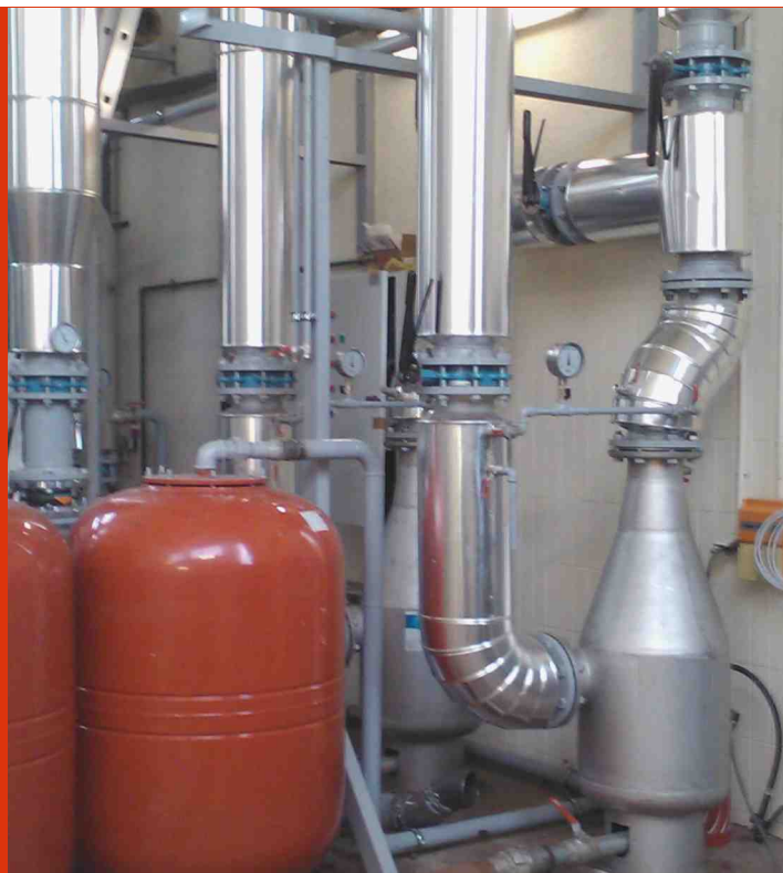
2 filtres HM 100 dans chaufferie
